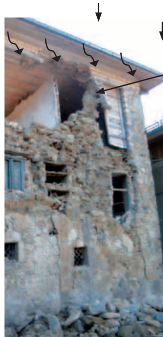
Fig. 2 - Forze orizzontali spingenti dovute al sovraccarico strutturale del tetto in c.a.
