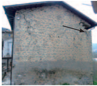
Fig.1 - Assenza di muri di spina, e presenza di un cordolo di coronamento in c.a., assenza di ancoraggi ai piani
